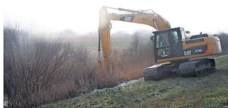
Phase 1 der mehrjährigen Gehölzarbeiten am Grauwall-Kanal (hier bei Dorum): Totholz und junge Gehölze werden abschnittsweise abgefräst. Ziel ist es, die ungehinderte Entwässerung zu gewährleisten. Foto: Leuschner
