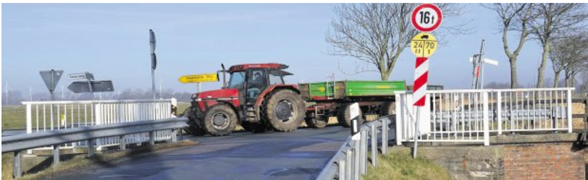
Aus Sicherheitsgründen wurde die maximale Gewichtsbelastung für die Brücke an der K 5 zwischen Wanna und Lüdingworth bereits auf 16 Tonnen begrenzt. Doch das reicht nicht, um langfristig das Problem in den Griff zu bekommen. Ein Neubau ist nötig: Ob und wann er kommt, bleibt unklar. Foto: Schröder
