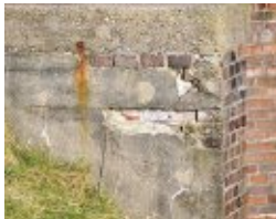
An vielen Stellen der Brücke sind bereits heute Mängel sichtbar.
