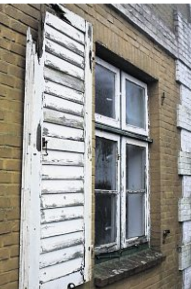
Zwei Sanierungsfälle, die nun mit Mitteln aus der Deckungsreserve angepackt werden sollen: Das Gärtnerhaus im Schlosspark und der Penzancer-Platz im Zentrum, der nicht außen vor bleiben soll, wenn die Nordersteinstraße ihr neues Pflaster erhält.
